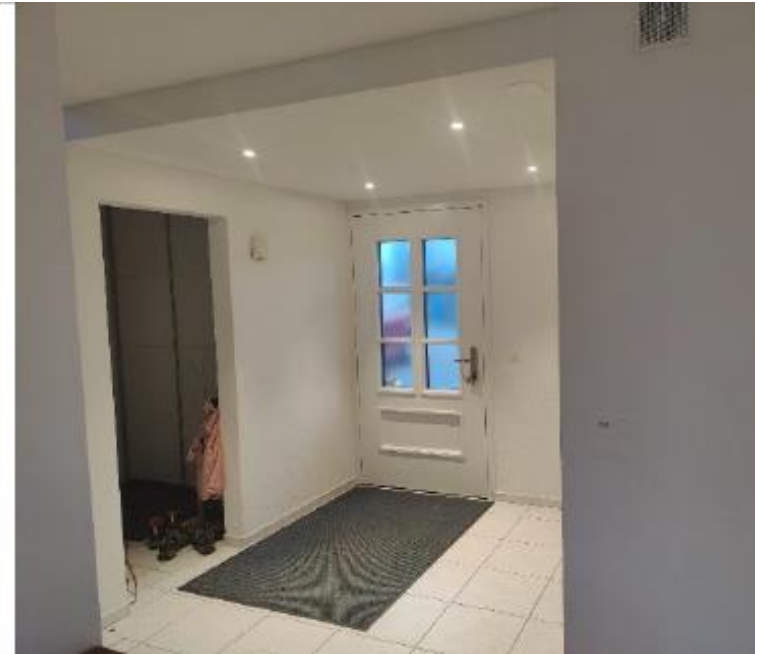
Lüftungsleitungen verkleidet Beleuchtung integriert
